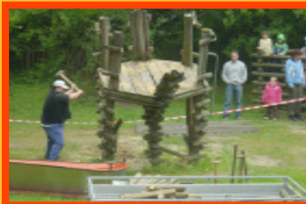
Alt und nicht mehr den DIN -Normen entsprechend - manchmal hilft da nur noch eins - Abriß
